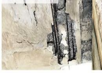
鋼筋鹽害鏽蝕
