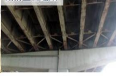
鋼構鹽害鏽蝕
