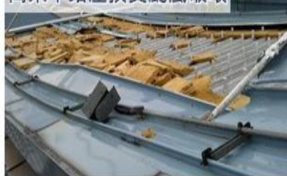
高架車站屋頂受颱風破壞
