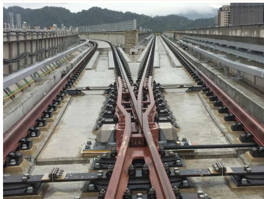
臺中捷運綠線可動式岔心道岔
