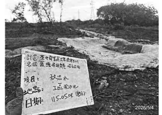
圖 2.4-1 本季龍井機廠放流設施現況圖
